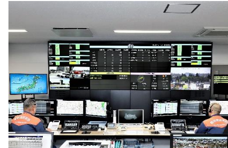
消防・救急通信指令システム
