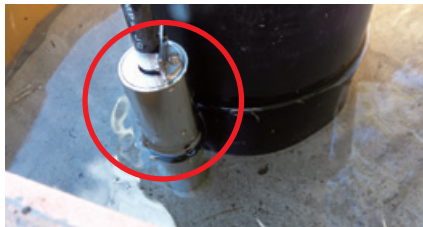
長野県飯田市様で実証実験を行った「浸水アラートシステム」の浸水センサー (電柱の下部に設置)
