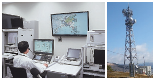
住民のみなさまの安心・安全を支える 防災無線システム
