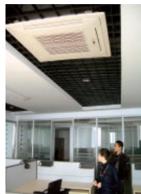
ビル内に設置された室内機
