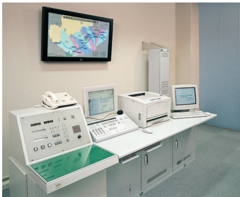
防災センター 操作卓
