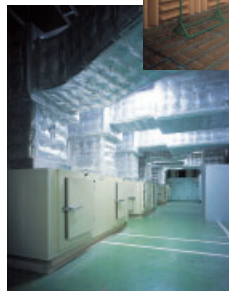
暗騒音12dBを実現する 低騒音空調設備
